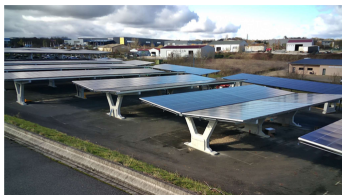
Ombrières de la Glèbe (12) - 16 km 2 de parking équipé
